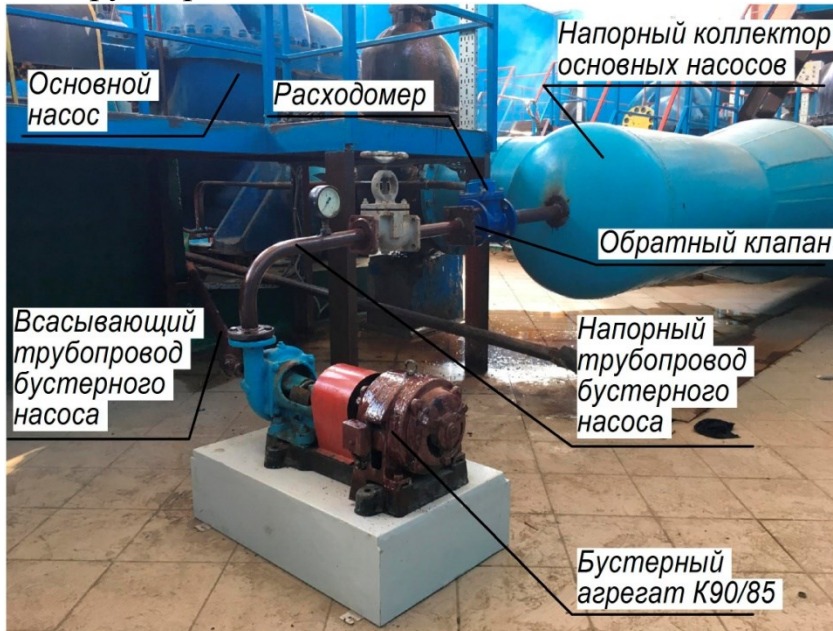
Рисунок 4 – Внутренний вид насосной станции «Междуречье» с основным и бустерным насосом
